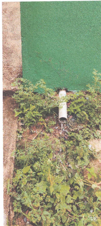
Foto 08: Despejo de água servida a céu aberto.
